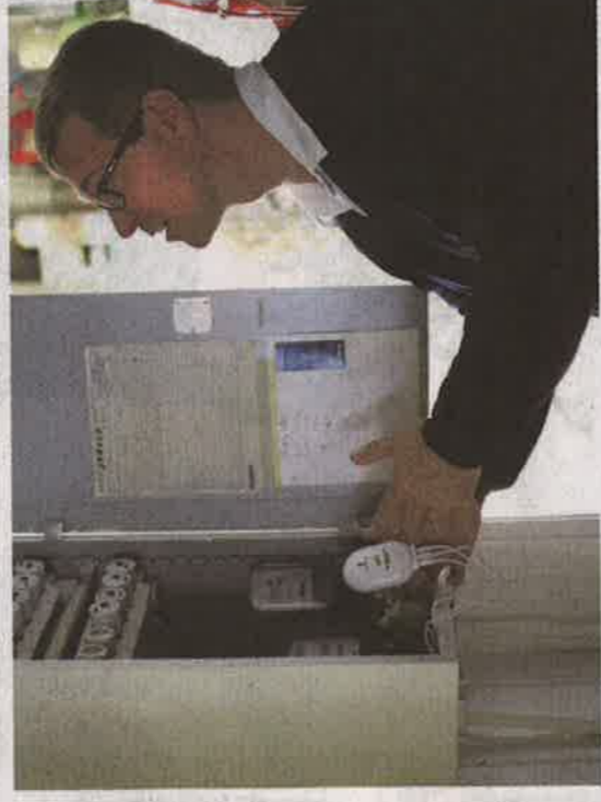
OVERVÅKER: Nils Tore har koblet en liten maskin til ledningene inne i strømskapet. Den sender informasjon til mderen på veggen.
